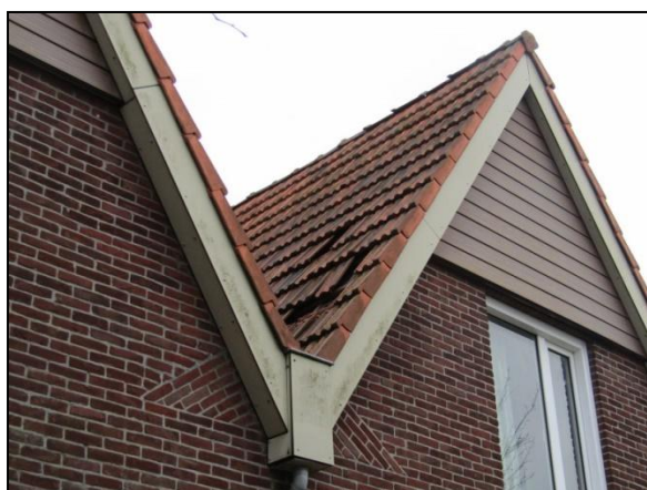
Figuur 9. Losse dakpannen geven toegang tot de ruimte onder het dak.
