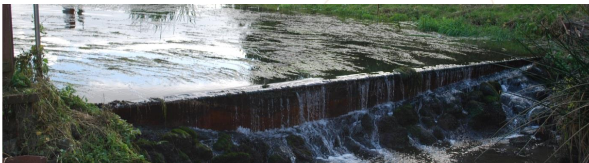
Figuur 6.7. Schuifconstructie in vispassage in de Maas (dichtgezet).
