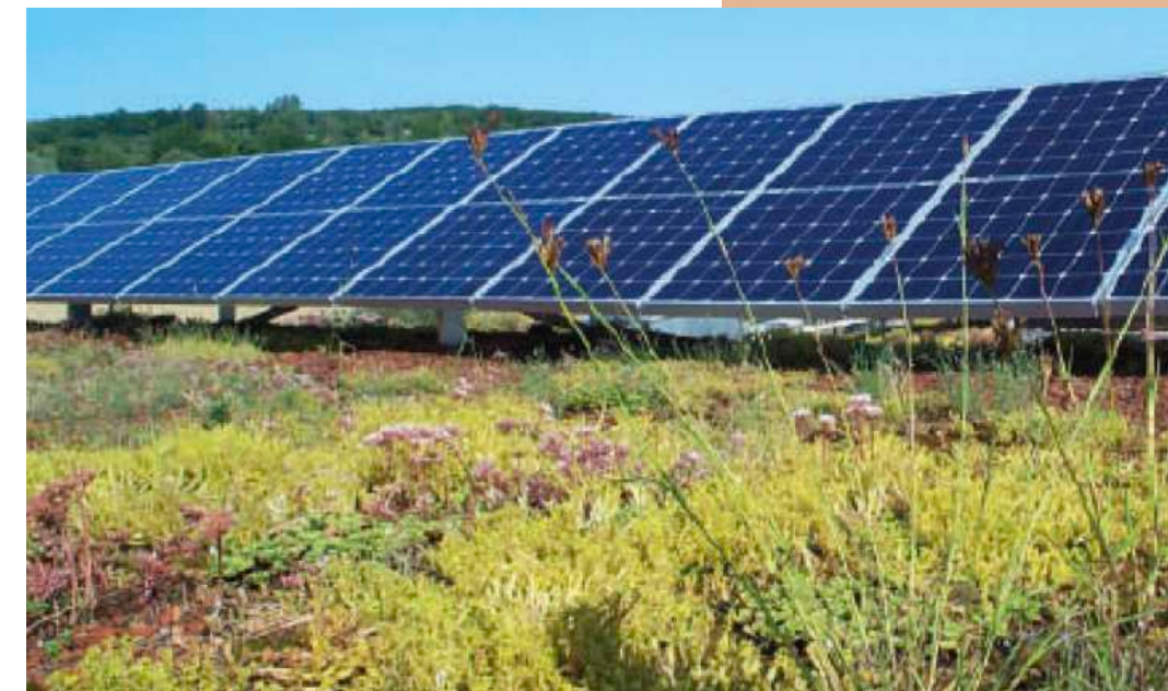
Combinatie van groen dak met zonnepanelen.
