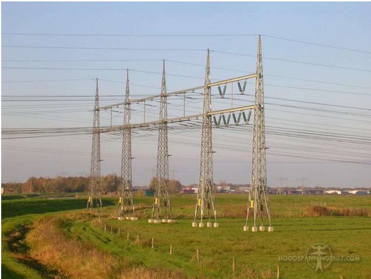
Figuur 1 Weergave van elektriciteitsportalen. In deze studie kan een ander type portaal gebruikt worden. Bron: https://www.hoogspanningsnet.com/mastsoortenclassificatie/portaalmast/
