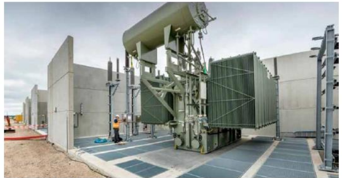
Referentiebeeld transformator in open ombouw van beton.
