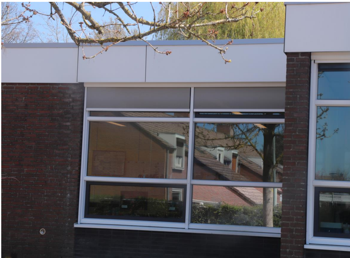
Foto 3: De trespa-beplating zit behoorlijk strak gemonteerd tegen de muur. Er zijn geen open stootvoegen in het pand.
