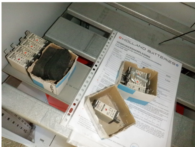
meszekeringen in opslag, niet asbestverdacht
