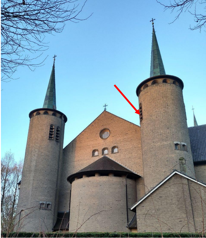
Afbeeldingen 3-7: Aangetroffen kraamverblijfplaatsen via open stootvoegen en via daklijsten en één winterverblijfplaats via de galmgaten van de noordelijke toren van de kerk aan de Zuiderstraat 28, de Sint Jozefslaan 105 en de Sint Jozefskerkplein. Bron: A. Pulcher, datum: 22-11-2024
