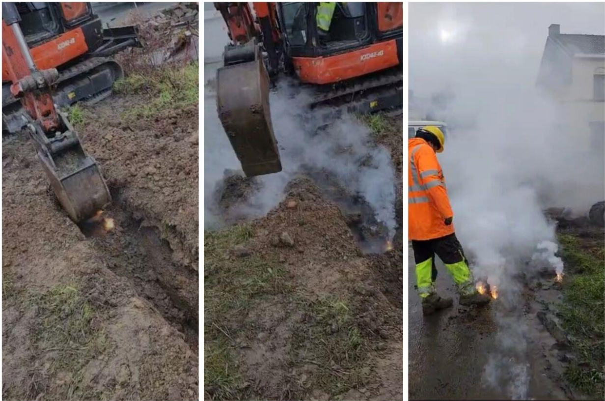
Figuur 33: Voorbeeld van een fosforbrand (Bron: www.VRT.be Ontmijningsdienst waarschuwt na incident met fosforbom in Ieper: "Schoppen tegen rokende restanten is not done" 8 )
