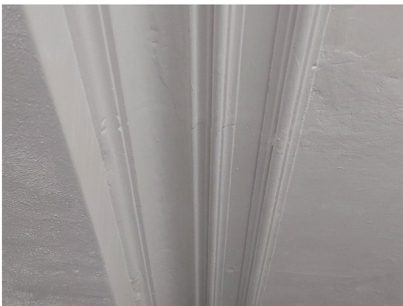
Detail van de profilering van de randlijst van het plafond uit omstreeks 1895.
