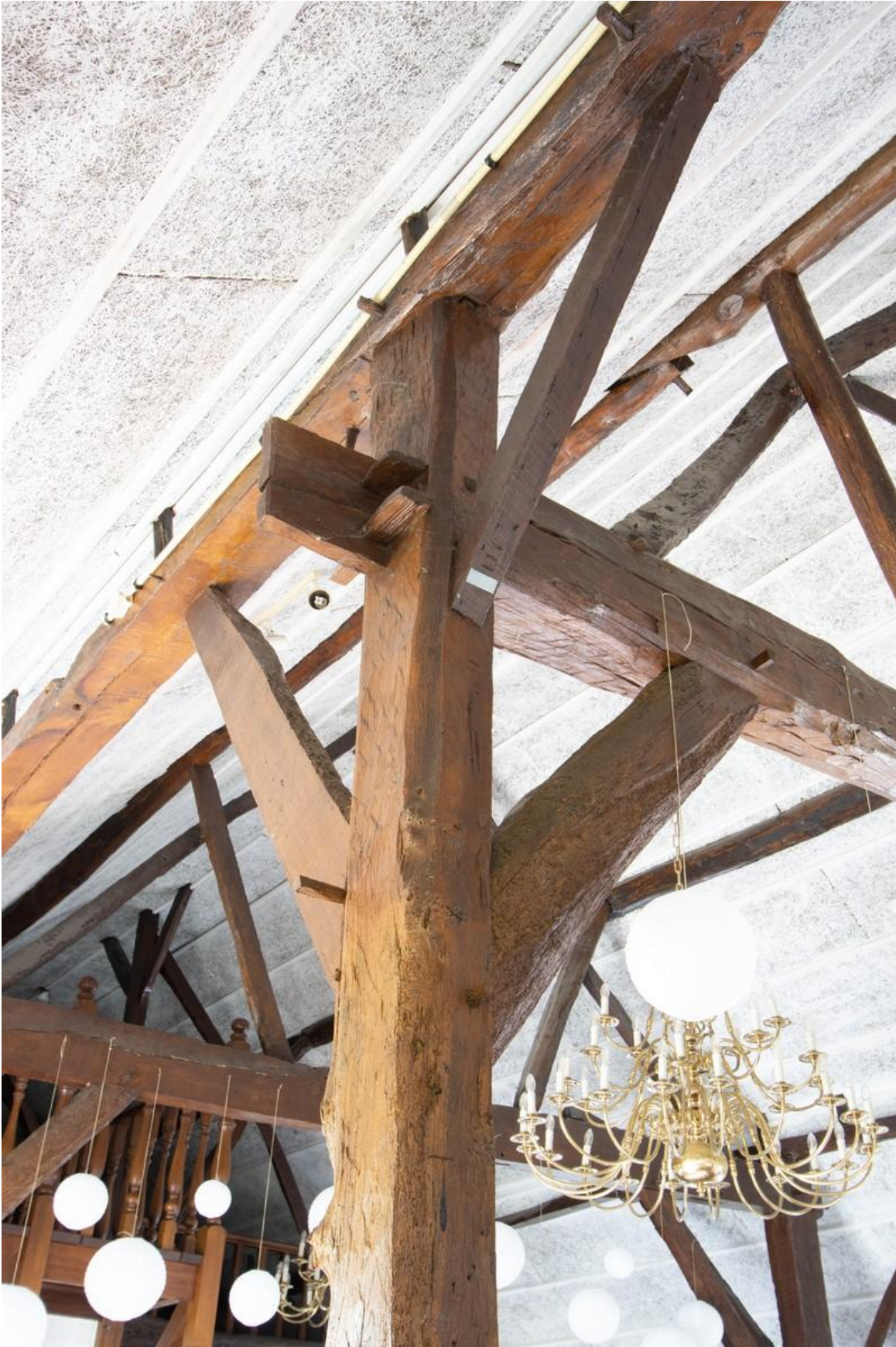
Opname waarop een windverband (met daarop telmerk [III]) hoger is aangezet daar waar vroeger een deel is geweest. Ankerbalk is met wigen en een toognagel vastgezet aan de gebintstijl.
