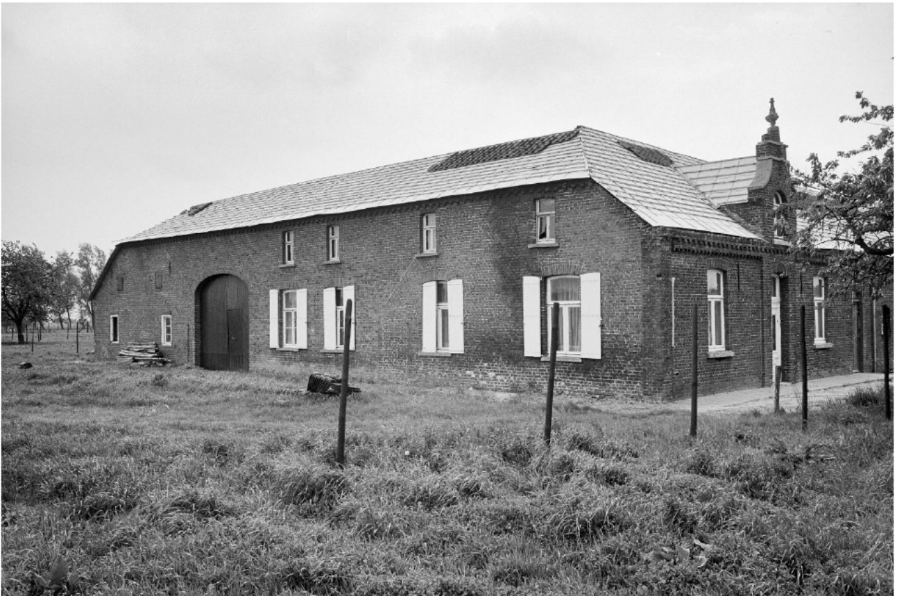
Opname in het archief van de Rijksdienst. Pannen zijn van het dak gehaald, er gaat grootschalig verbouwd worden (RCE – 175746).
