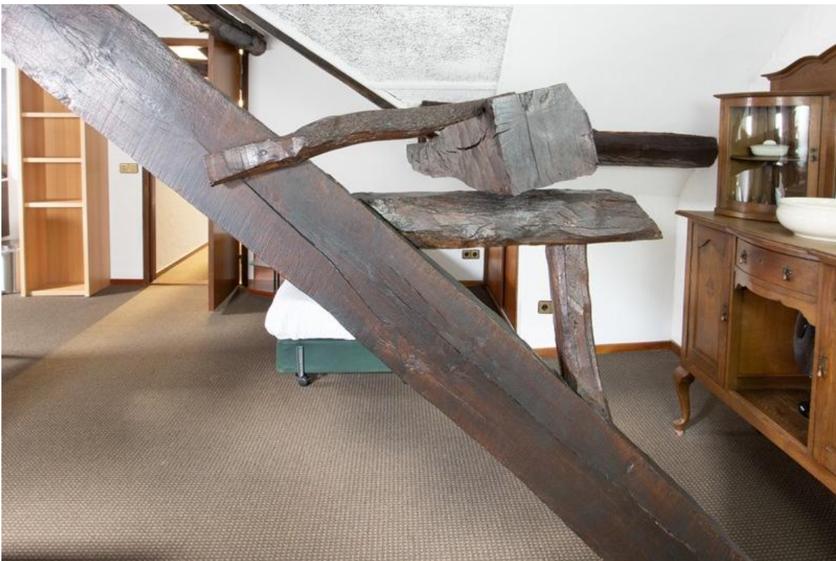
Detail van de oplegging van de gordingen. Op het spantbeen is nog vrij duidelijk te zien dat bij de vervaardiging nog met handkracht is gezaagd.
