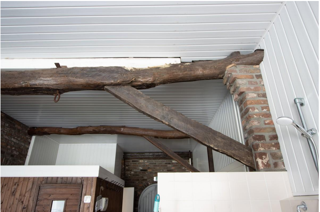
Detail van een moerbalk in het douchegebied, opgelegd en afgeschoord op een twintigste-eeuwse penant van hergebruikte bakstenen in portlandcement.
