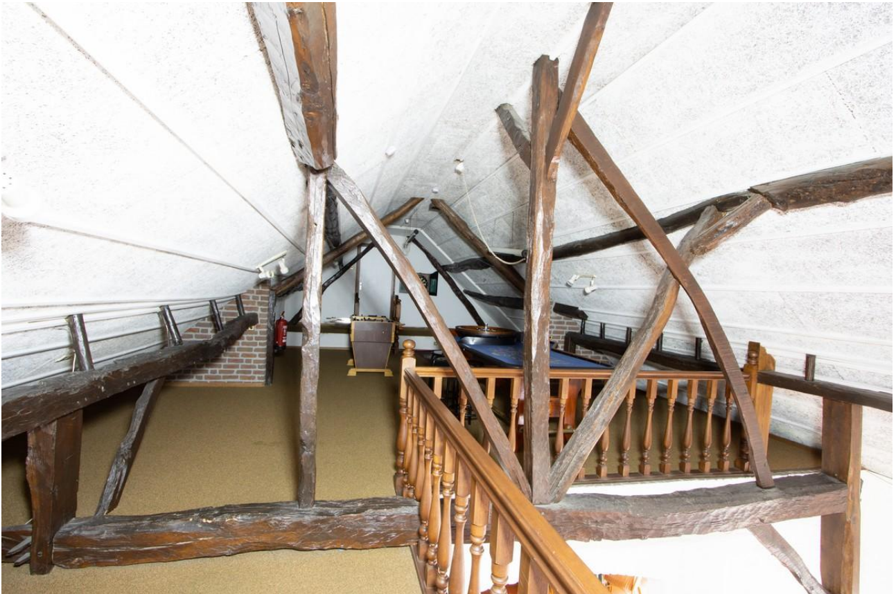
Schaarspant boven het 'vierde' gebint, aangepast door de kap vanwege hogere gevels op te lichten, wat nieuwe gordingen nodig maakte (zie toegevoegde stijltjes op de gebintplaten). Gordingschoren dateren ook uit die tijd. Eén van de nokstijlschoren is verwijderd (zie pengat bovenin de ankerbalk links).
