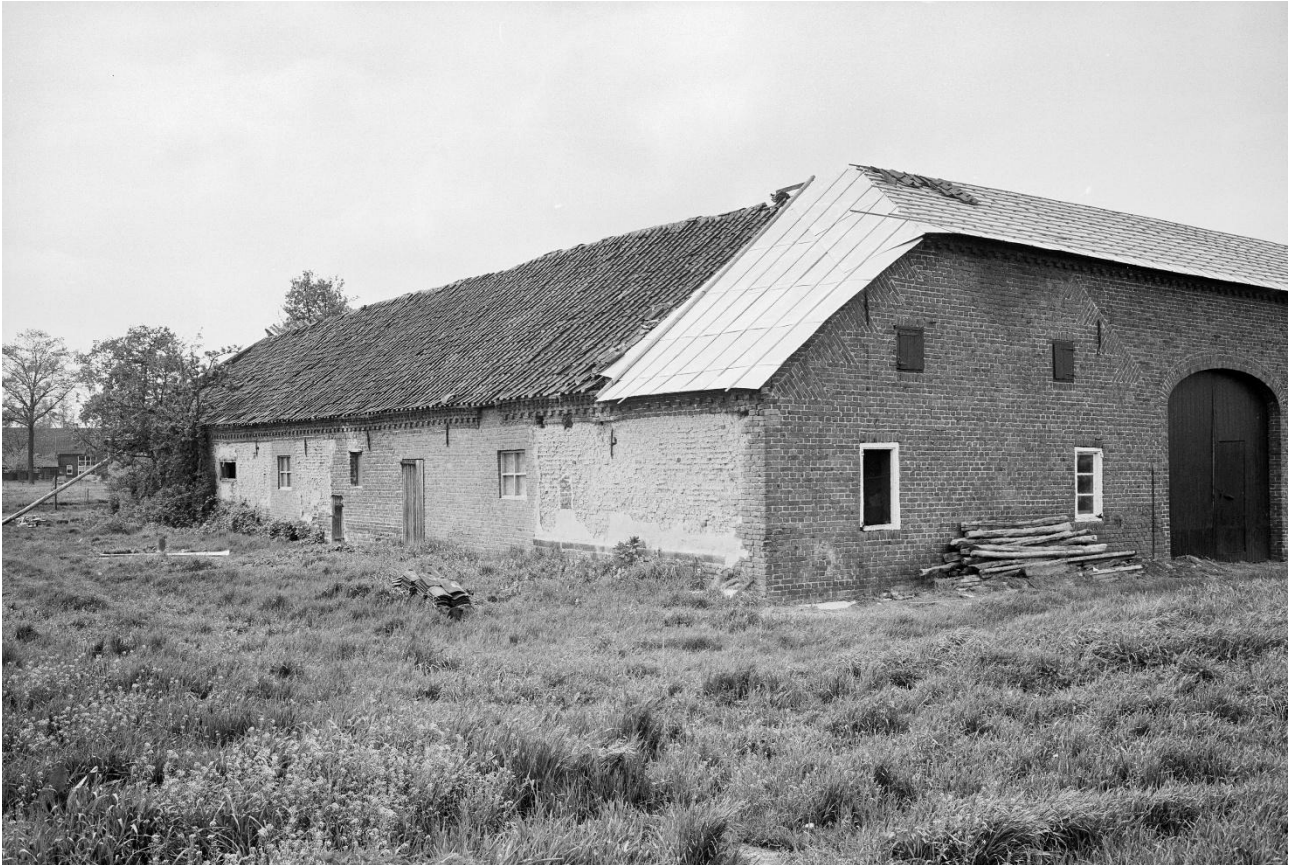
Opname in het archief van de Rijksdienst. Pannen zijn van het dak gehaald, er gaat grootschalig verbouwd worden. Op deze foto is duidelijk te zien dat de gevel links in beeld veelvuldig is gewijzigd. De gevel zou in de jaren tachtig worden gesloopt (RCE – 175747).
