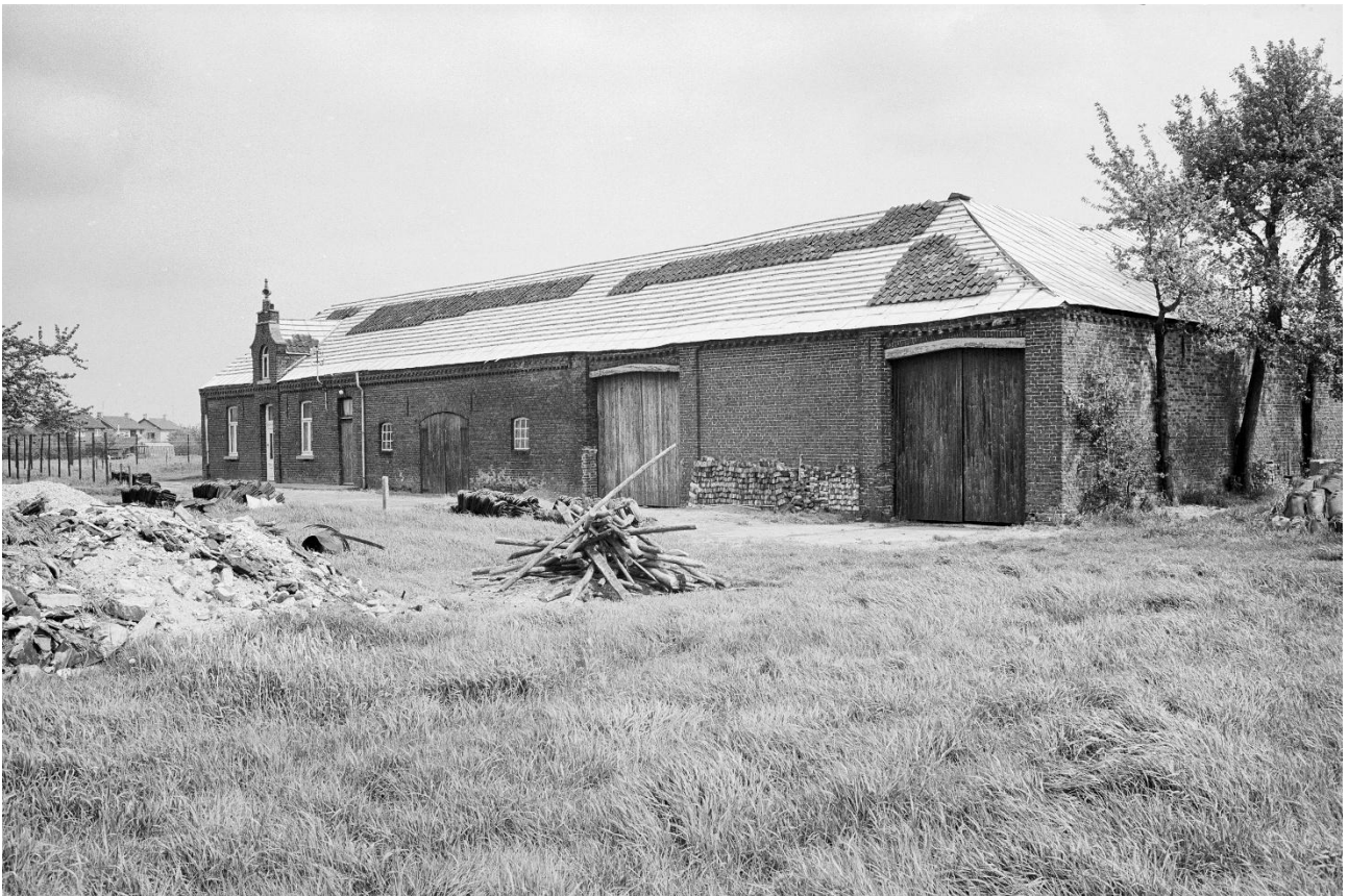
Opname in het archief van de Rijksdienst. Pannen zijn van het dak gehaald, er gaat grootschalig verbouwd worden (RCE – 175744).
