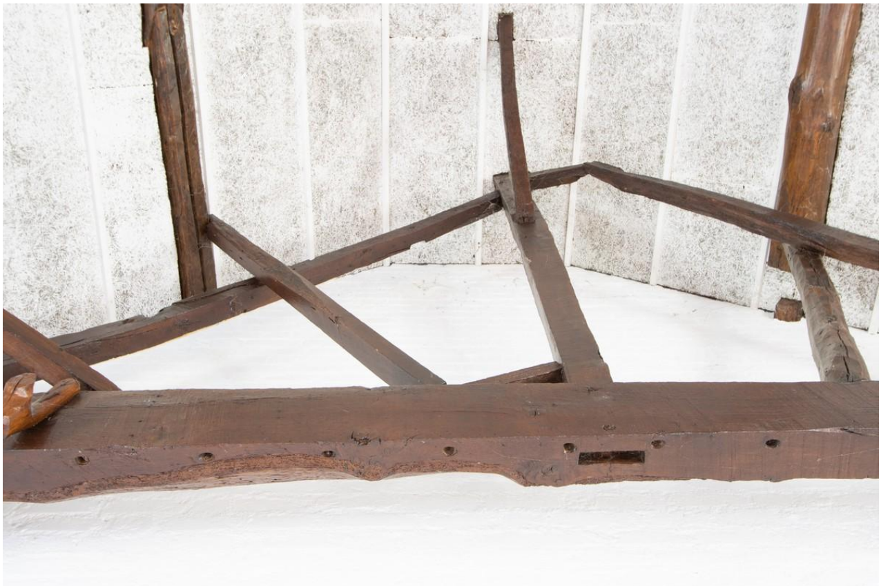
Deel van de ankerbalk met daarin een reeks gaten ten behoeve van vlechtstaken.
