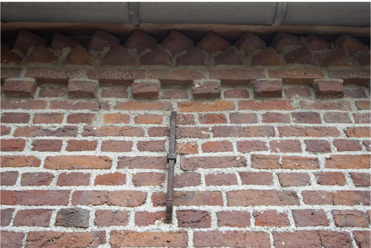
Laat negentiende-eeuws gevelanker en daarboven de kroonlijst met bloktand en dubbele muizenrand. Voegwerk vernieuwd, stenen gereinigd.
