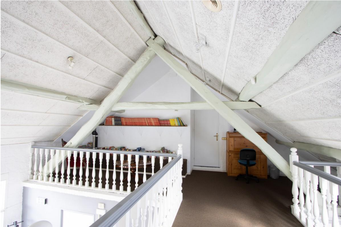
Laat negentiende-eeuws spant op de plek waar in het verleden de korte rechter zijgevel van de boerderij die we van de kadastrale minuut kennen, heeft gestaan.
