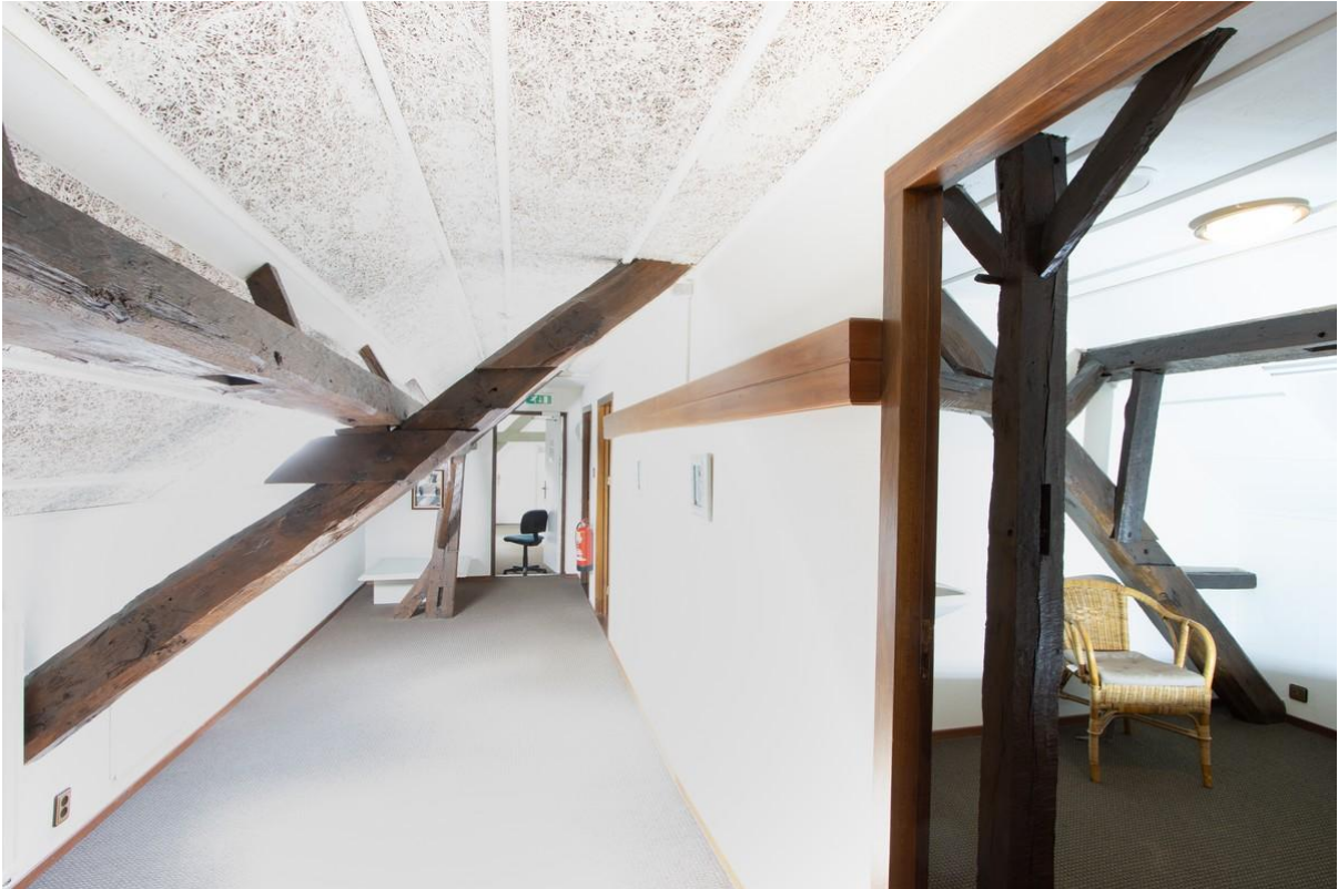
Eén van de laat negentiende-eeuwse kapspanten, gepositioneerd op een moerbalk uit dezelfde tijd. In de voorgrond (door het deurkozijn) is een oudere nokstijl te zien die thans op een binderbint staat.
