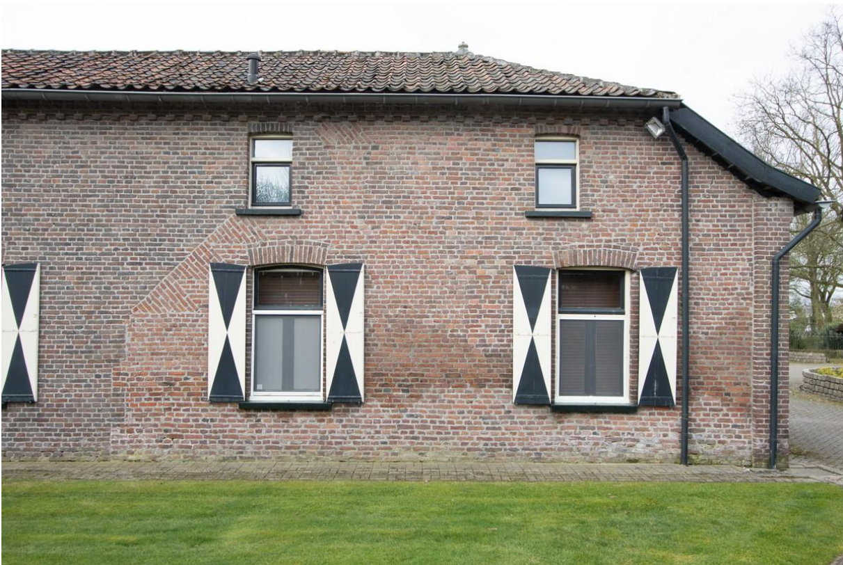
Op basis van bouwsporen is in de gevel de oudere opzet van vóór eind negentiende eeuw deels te reconstrueren.
