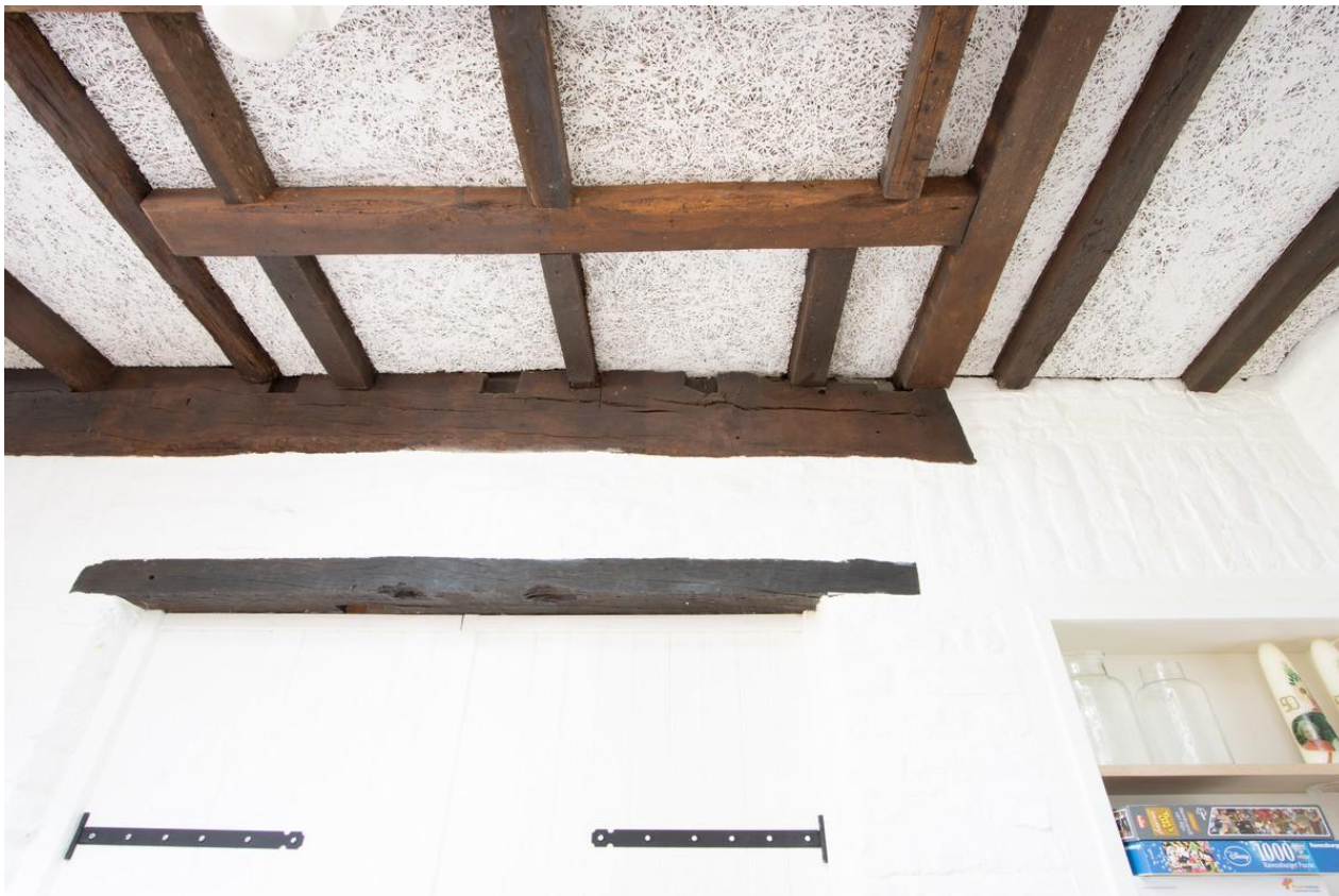
Aanpassing van de zoldervloerconstructie in de hal blijkt onder andere uit in onbruik geraakte inkepingen voor binten in één van de moerbalken.
