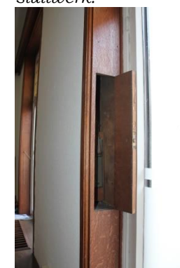
Afb. 59 'Kastje' in dagkant venster met bediening rolluik.
