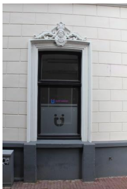
Afb. 19 Het venster, rechts in de gevel is niet authentiek. Hier zat voorheen een deur (o.a. herkenbaar aan afwijkend oijef).
