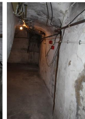
Afb. 32 Later aangebrachte gang om beide kelders te verbinden en ontsluiten.
