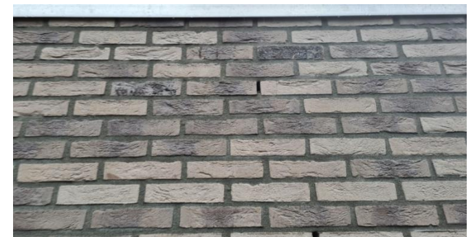
Figuur 6: Open stootvoegen in de noordgevel
