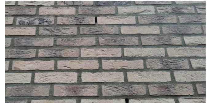
Figuur 6: Open stootvoegen in de noordgevel
