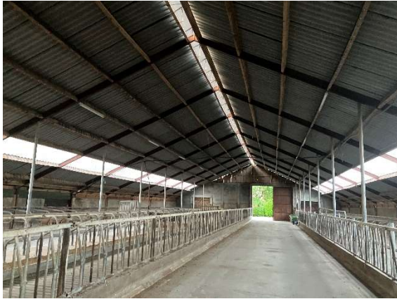
Afbeelding 3a: Impressie van noordelijke stal; dak bestaat uit niet geïsoleerde golfplaten (enkelwandig).
