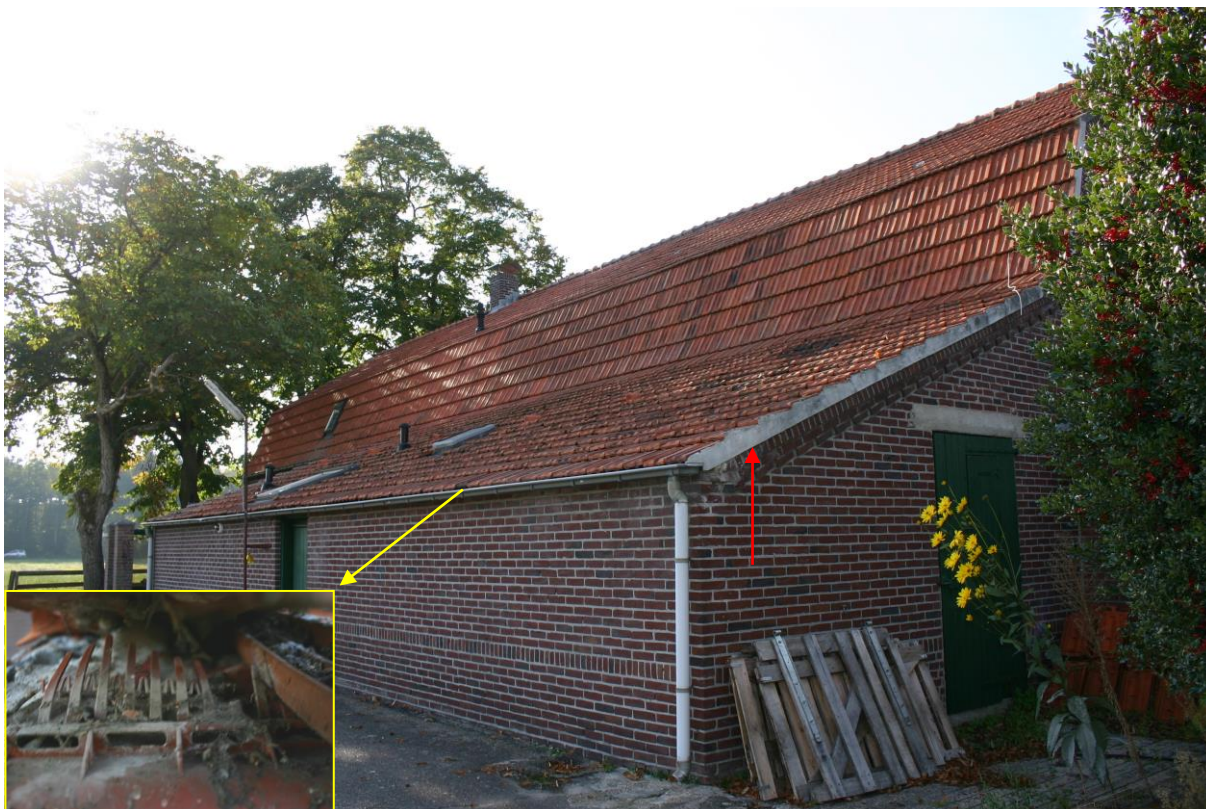
Figuur 4.2.3. De ruimte onder de dakpannen van de aanbouw bevat vogelschroot (gele pijl; zie kleine foto). De dakpannen zijn op de kopgevels afgewerkt met specie (rode pijl).
