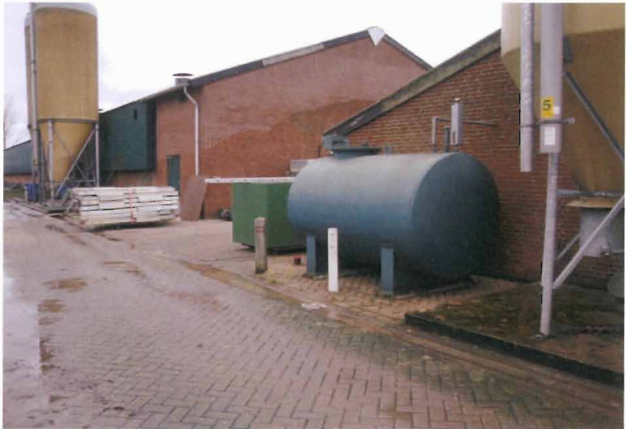
foto 1: bovengrondse dubbelwandige dieselolietank (circa 5.000) op klinkerverharding, aangrenzend ten noordwesten van de meest noordelijk gelegen varkensstal.
