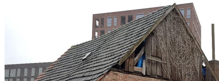
Figuur 13: Oostgevel van oude industriële bebouwing op de binnenplaats, met openingen naar de zolderruimte door missend houtwerk
