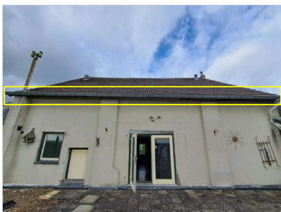
Figuur 4.3 Ruimte tussen de dakgoot en dakpannen (geel omkaderd).
