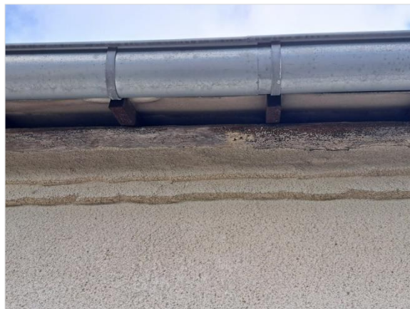
Figuur 4.2 Kier onder de dakrand.
