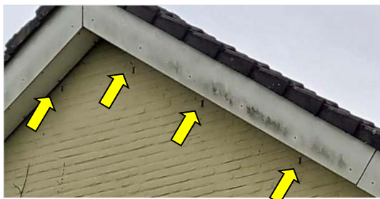
Figuur 4.5 Open stootvoegen geven toegang tot de spouwmuur.
