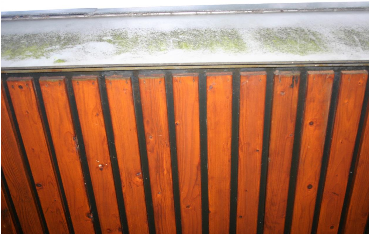
Figuur 14. Onder de planken onder het overstekend dak is zwart doek gespannen.
