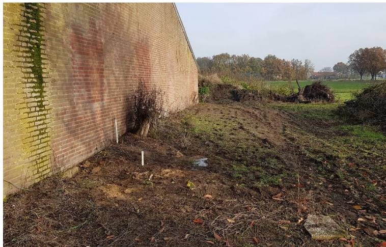
foto 4: voormalige ondergrondse HBO tank (22 november 2019)
