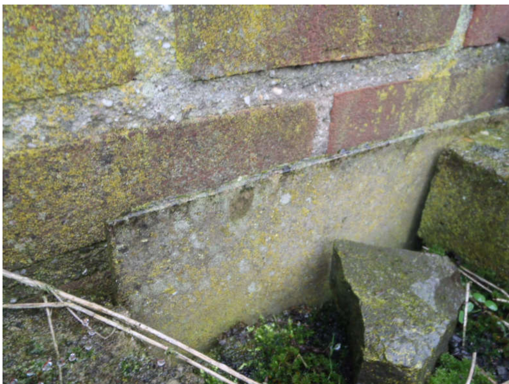
Foto 3: Golfplaat tegen gevel bij PV 8
