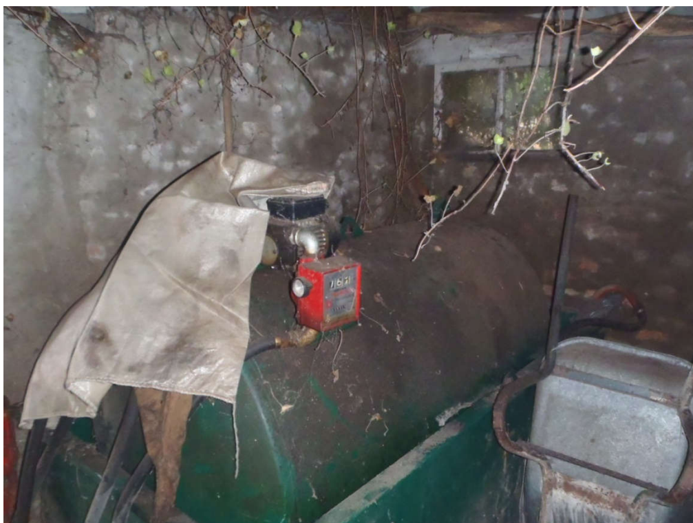
Foto bovengrondse tank in lekbak
