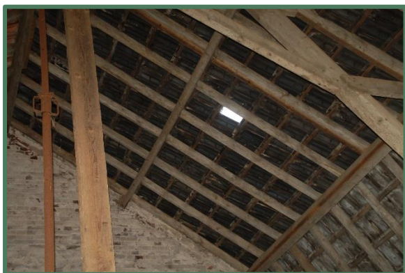
Niet onderschoten dak
