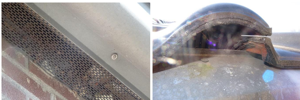
Afbeelding 11 en 12: Dak woonhuis afgesloten met gaas en vogelschroot. Bron: R.J.L. Bijvelds 29-03-2021
