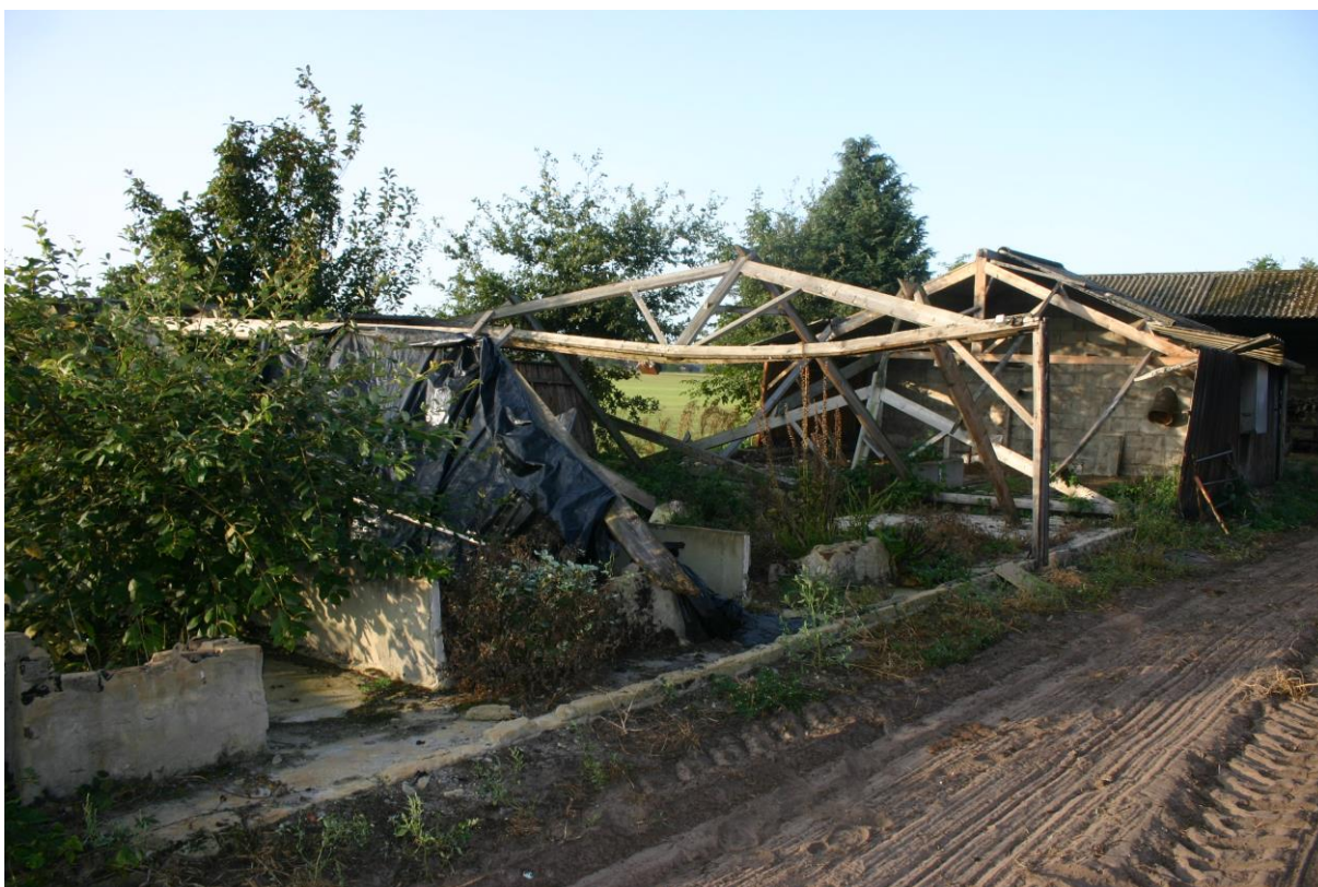
Figuur 4.2.2. De ingestorte voormalige varkensstal (2 in figuur 4.1) is volledig enkelwandig.
