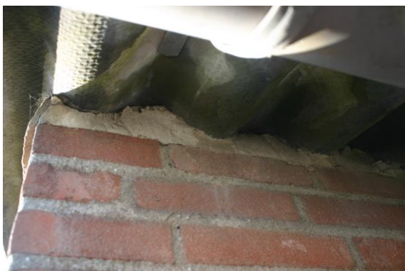
Figuur 4.2.5. De ruimte onder de cementhoudende golfplaten bij stal D is met specie afgewerkt.
