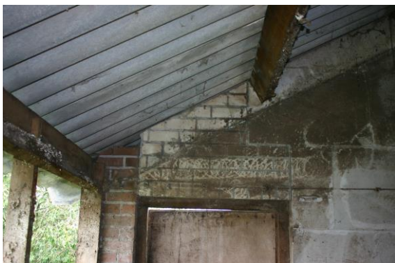
Figuur 4.2.3. Bij de meeste stalcompartimenten waren de plafondplaten niet meer aanwezig.
