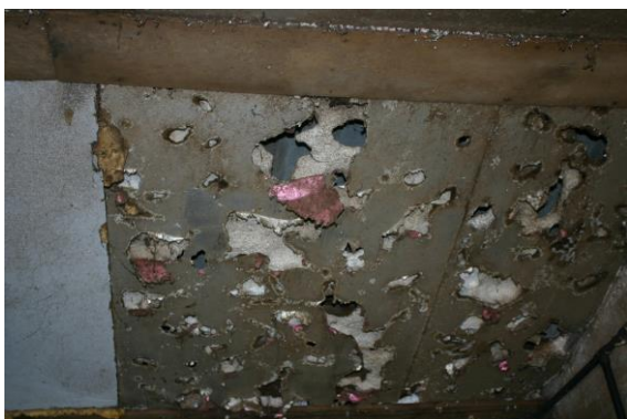
Figuur 4.2.4. De nog aanwezige plafondplaten zijn sterk aangevreten door zwarte ratten.
