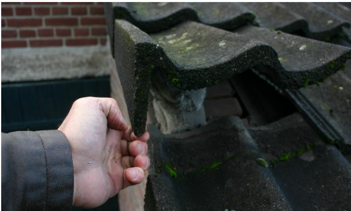
Figuur 4.2.4. De gevelpannen van aanbouw nummer 3 zijn vastgezet met specie.
