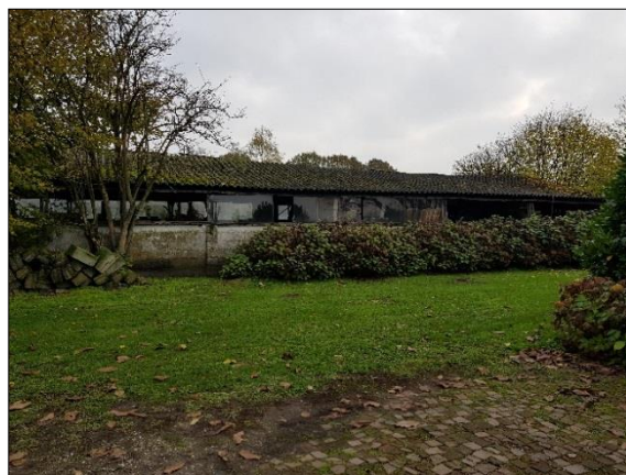
Figuur 5. Zuidelijke gedeelte vervallen stal
