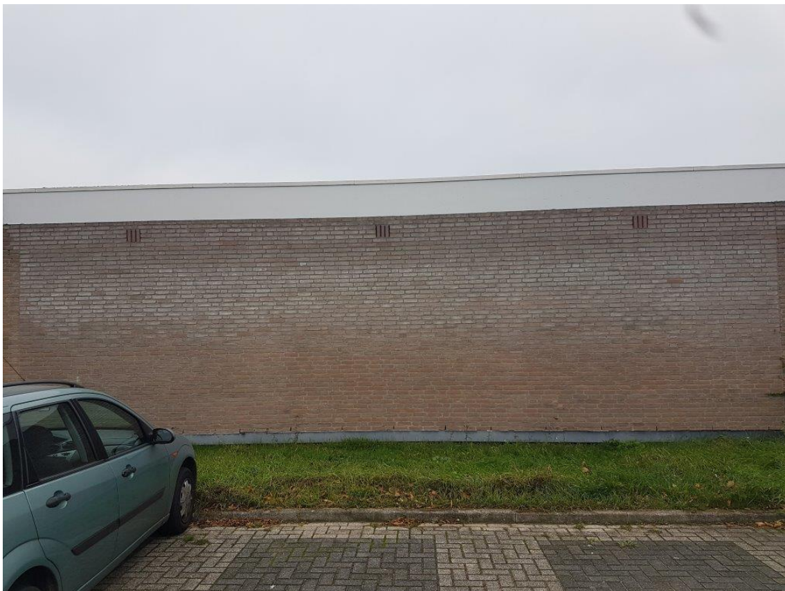
Stootvoegen met witte aanslag op de muur welke duidt op vocht in de spouw.
