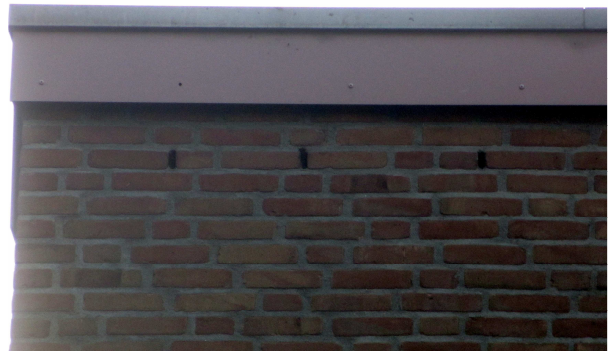
Fig. 8 Open stootvoegen in het meest oostelijke 3 laags appartement.
