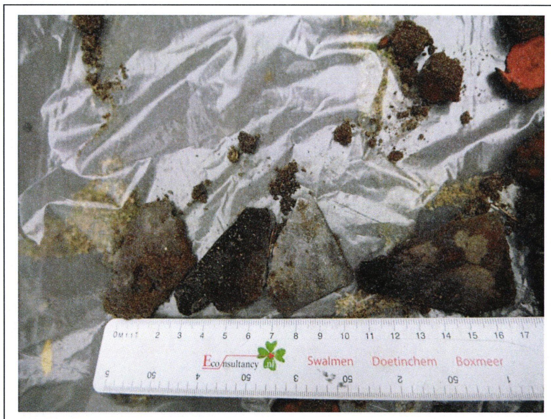
Gat 15 (asbestverdacht materiaal)
