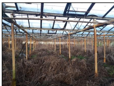
Figuur 6. Vervallen kassen deellocatie A.
