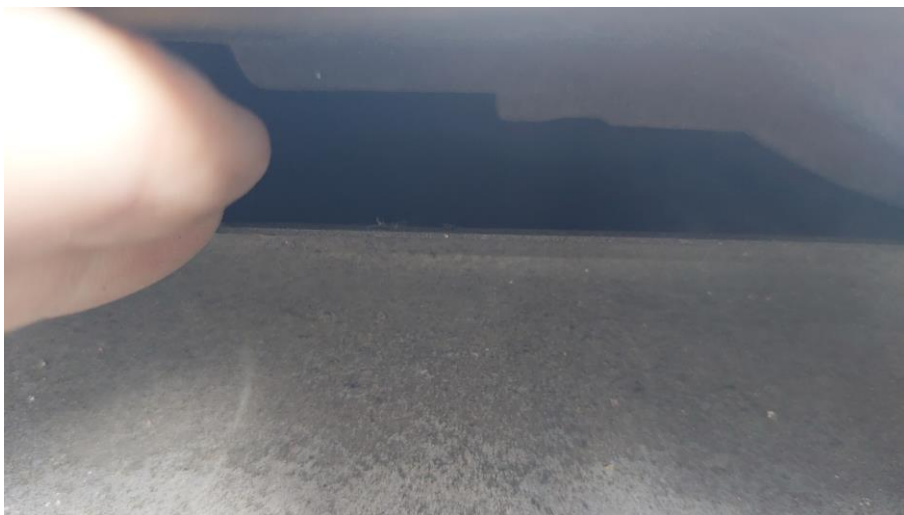
Figuur 4.2.4. Tussen de dakpannen en pannenlat is onvoldoende ruimte voor huismussen.
