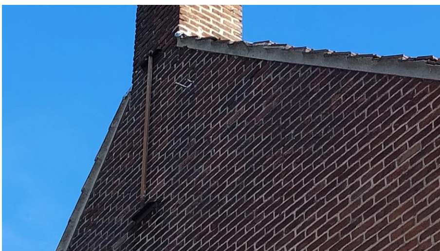
Figuur 4.2.5. De gevelpannen liggen in de specie; vogels en vleermuizen hebben hier geen toegang.
