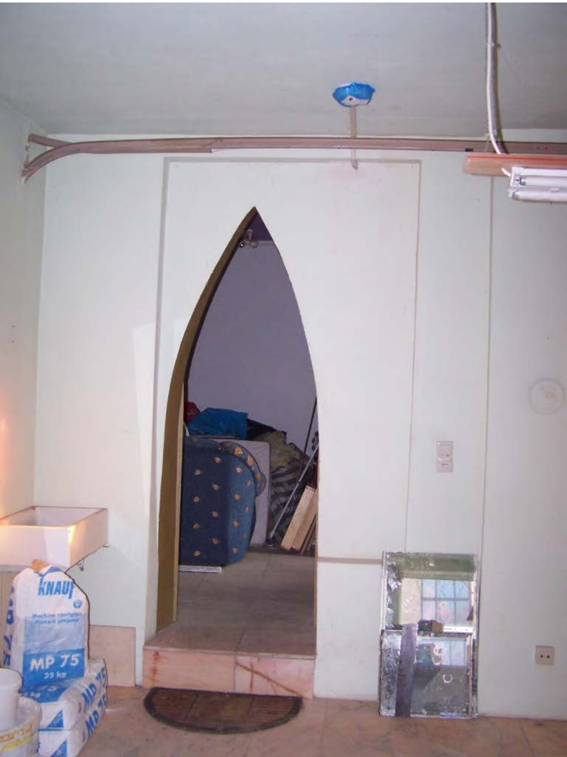
Foto 6. Dicht te maken opening
