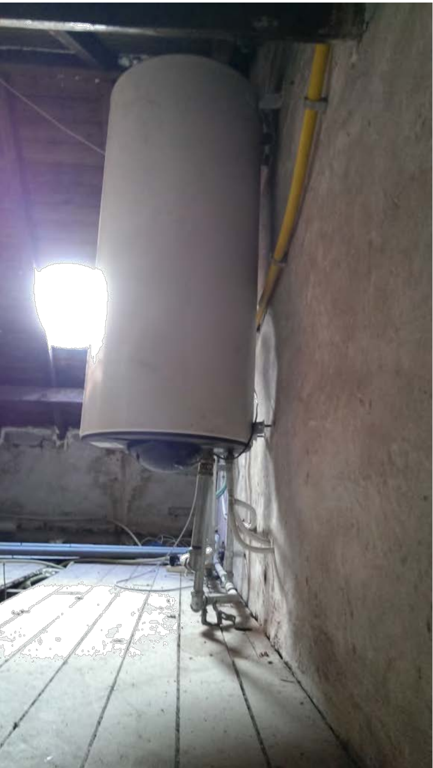
Foto 9. boiler op zolder, tbv W-installatie op 1e en 2e verdieping zolder is niet getekend
