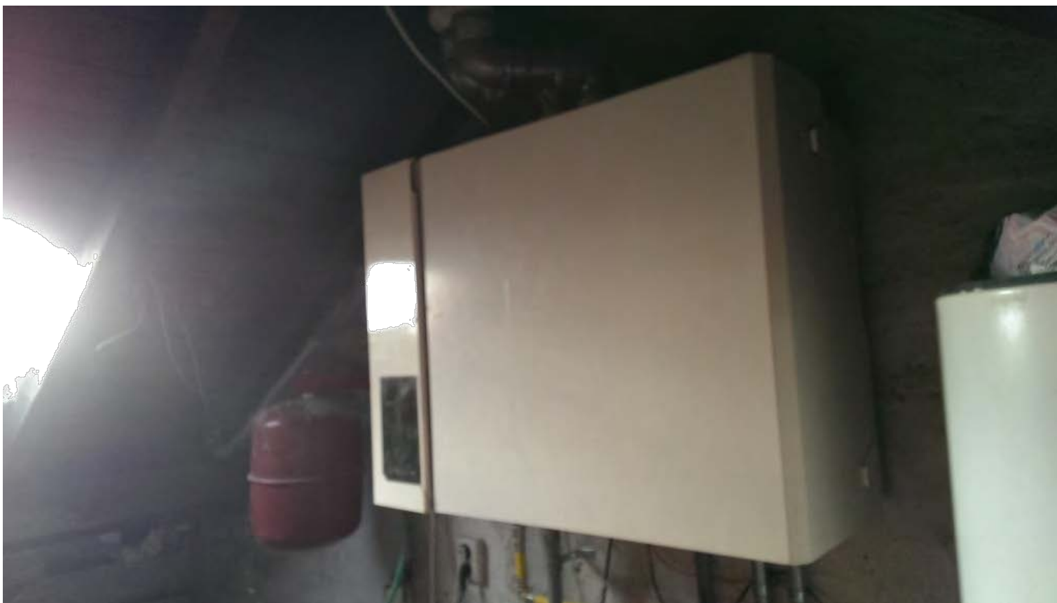
Foto 8. cv-ketel op zolder, tbv W-installatie op 1e en 2e verdieping zolder is niet getekend
