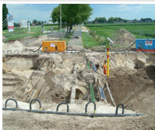
Kabels en leidingen
