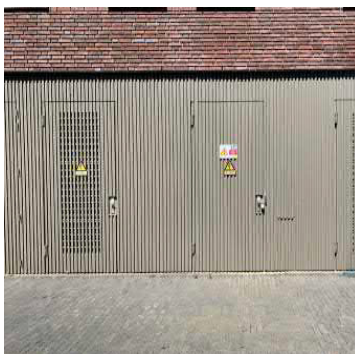
Traforuimte ingepast in de gevel
