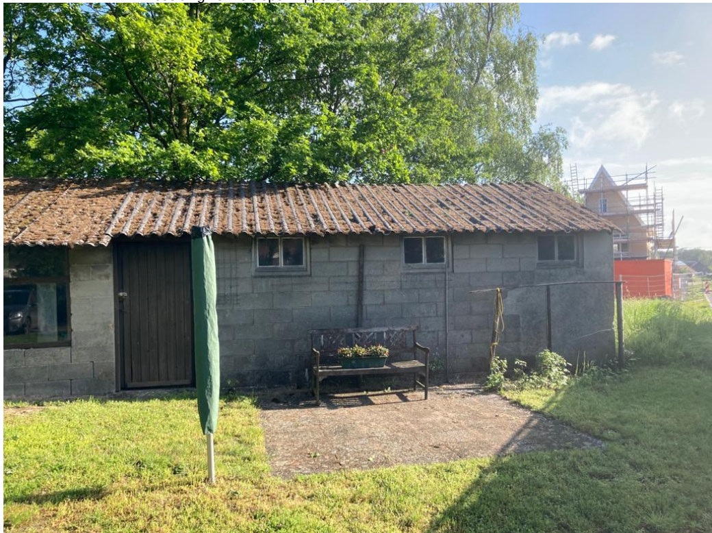
• Afbeelding 15: Te slopen kippenschuur
