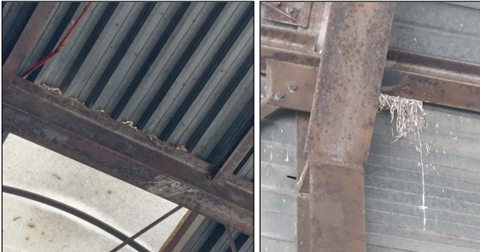
Figuur 2.2. Aangetroffen nesten in de bedrijfshal.
