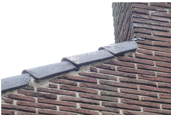
Afbeelding 9: Dakpannen aan de dakrand zijn aangesmeerd met cement, waardoor vleermuizen hier geen mogelijkheid hebben om onder de dakpannen/ in de spouwmuur kunnen komen. Bron: R.J.L. Bijvelds, datum: 30-06-2021
