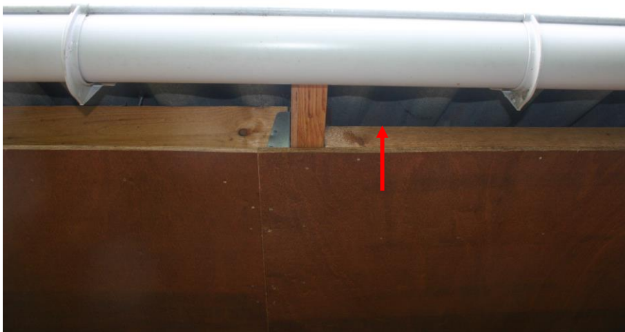
Figuur 4.2.3. De ruimte onder de ‘golven’ van de golfplaten is niet afgedicht (rode pijl), waardoor vogels de bebouwing binnen kunnen.
