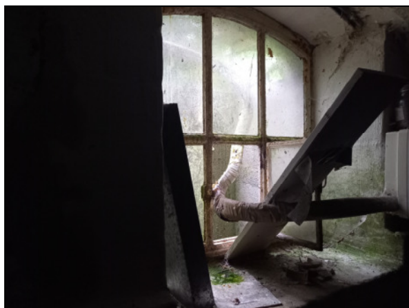
Foto 13: open raam biedt toegang tot kelder
