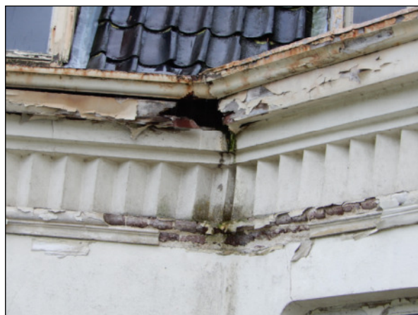
Foto 4: openingen in daklijst
