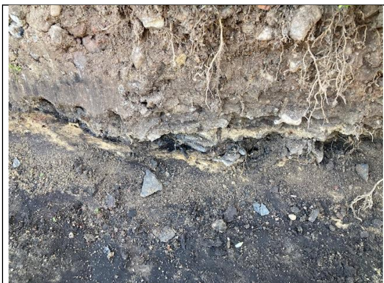
Foto 9: duidelijke restverontreiniging met asbestmaterialen bij de perceelsgrens
