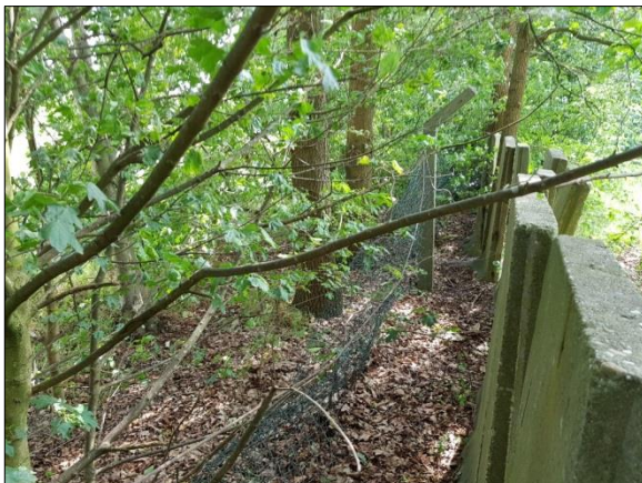
Figuur 13. Vervallen hekwerk noordoostelijke grens
