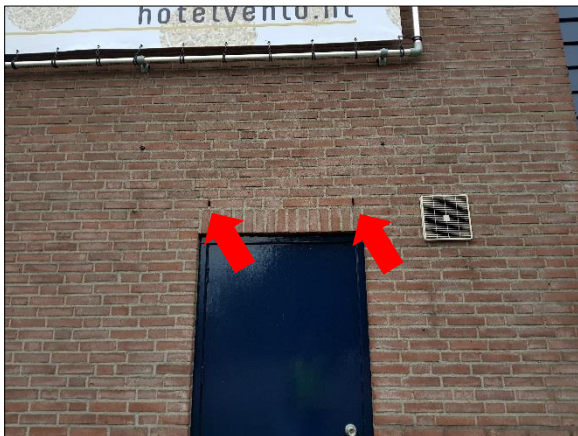
Figuur 15. Open stootvoegen aan westzijde gebouw
