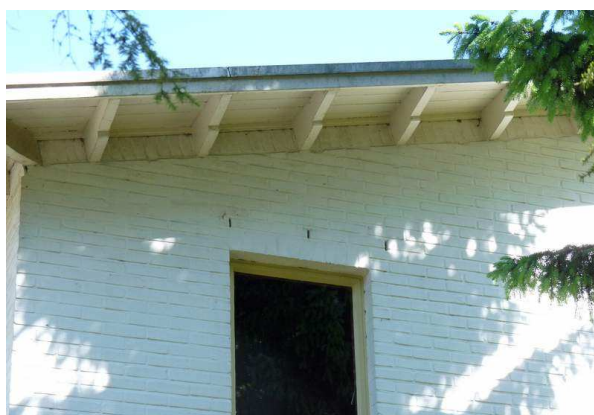
Figuur 10. Open stootvoegen in het woonhuis, aan de zuidzijde van het huis.
