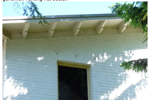
Fig. 10. Open stootvoegen in het woonhuis, aan de zuidzijde van het huis.
