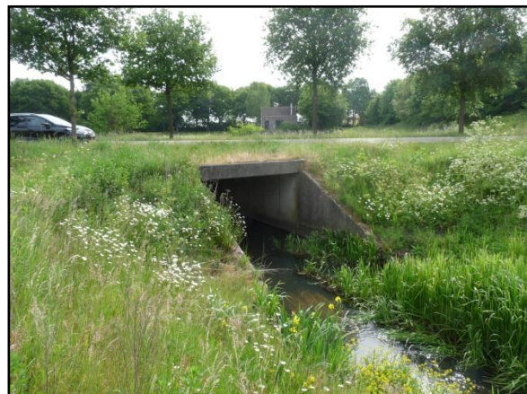
Figuur 13. Duiker onder de Venrayseweg grenzend aan de oostzijde van de onderzoekslocatie.
