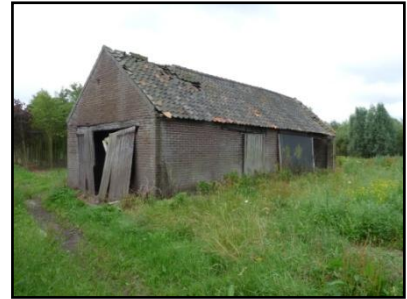
Figuur 11. Vervallen schuur op onderzoekslocatie.
