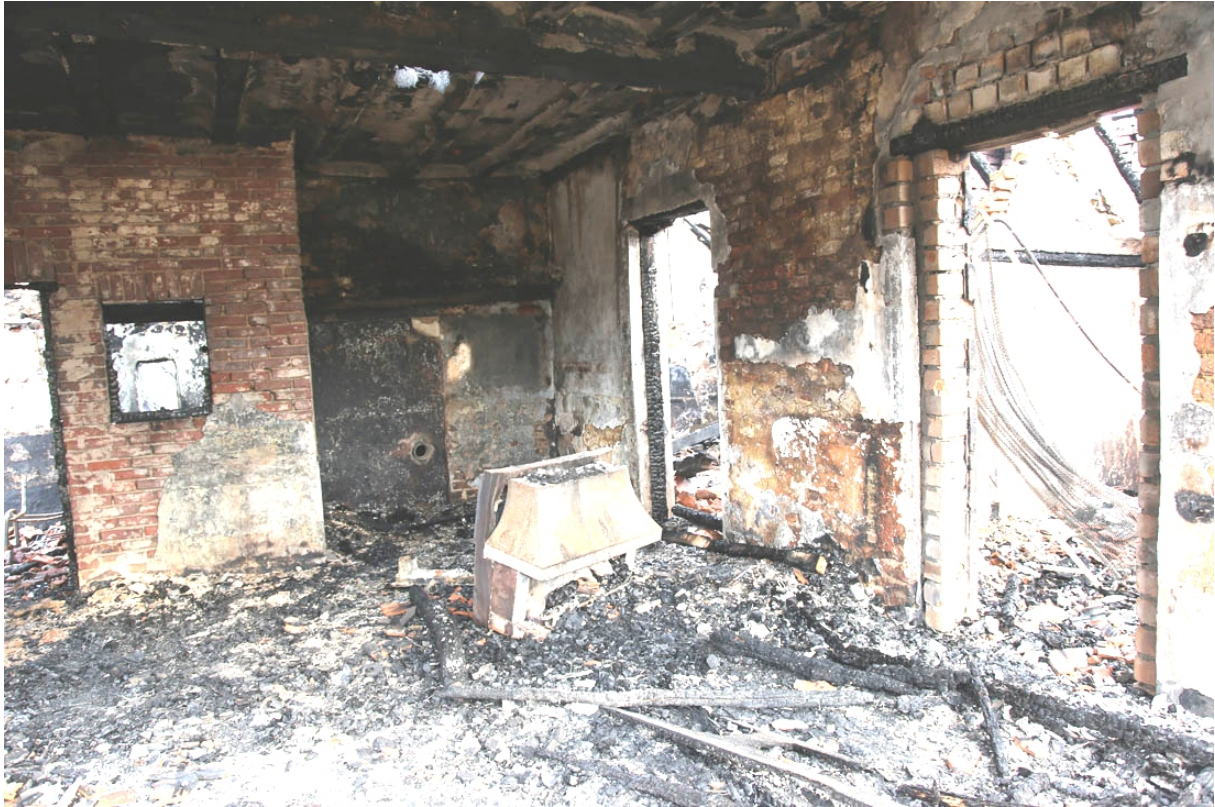
Afb. 5_ De woonkamer met moerbalk en gespelderd plafond. Door de brand is ook het 18e-eeuwse muurwerk van de rechter zijmuur in het zicht gekomen. Tegen de achterwand is nog een deel van de 18e-eeuwse schouwboezem en boezembalk zichtbaar. (foto Ton Desar, gemeente Venlo)
